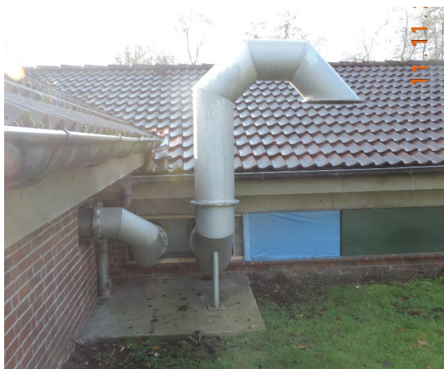
Bild 8: Zu- und Abluftanlage Reinwasserbehälter
