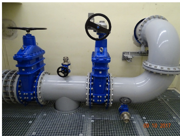
Bild 10: Reinwasserkammern Anlagenbau neu
