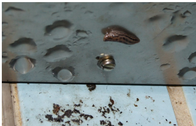
Bild 6: Schneckenbefall in Reinwasserkammer
