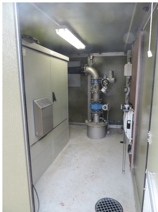
Bild 1: Blick in das oberirdische Brunnenhaus
