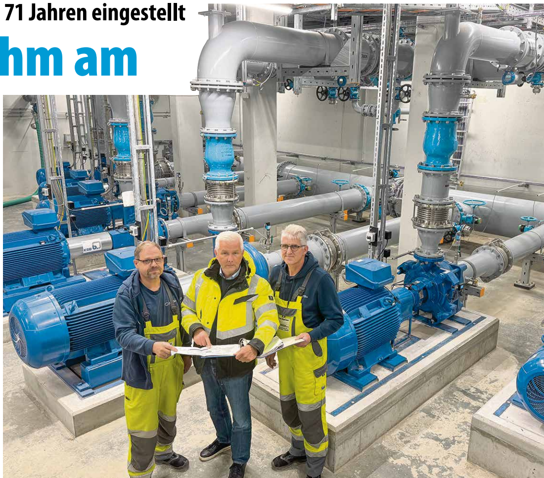
Baubesprechung im neuen Wasserwerk. Die Wassermeister Karl-Heinz Popp (li.) und Hans-Jürgen Axen (re.) haben kurz nach der Startphase im neuen Wasserwerk Linden einiges mit Marek Gagatsek, Ingenieur und Fachplaner für Anlagentechnik, zu besprechen.
