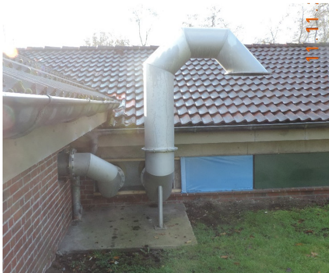
Bild 8: Zu- und Abluftanlage Reinwasserbehälter
